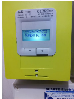
Compteur d'électricité HP
