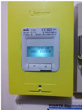
Compteur d'électricité HP
